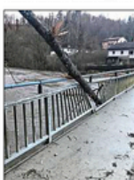
In die Brücke am Hochstein böhrt sich ein Baumstamm, der angeleitet wurde. – Foto: Landtag
