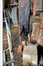
Die Holzmauern in der Scheune wurden von unten angezündet.
